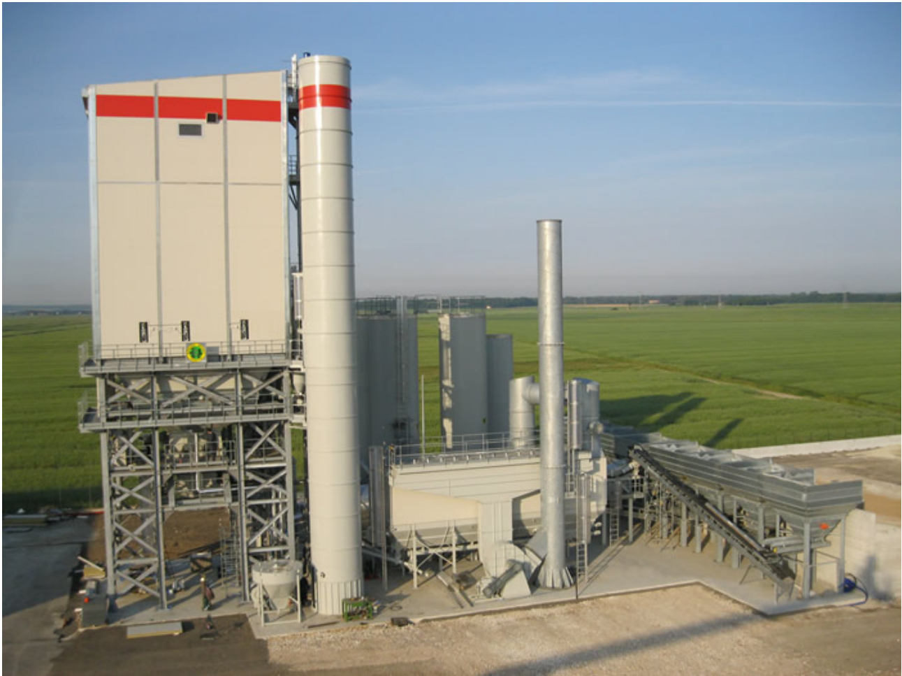
Figura 1 IMPIANTO PRODUZIONE CONGLOMERATI BITUMINOSI HOT STOCK PISA
